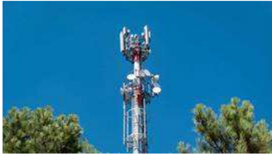
Mast in Denklingen 50 m Höhe
